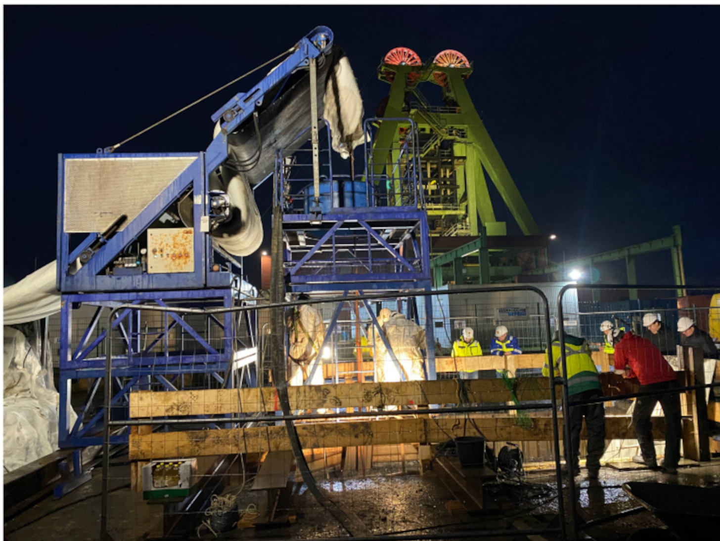
Installation: Inversion eines RS PolyLiners vor dem Förderturm der ehemaligen Zeche Haus Aden | Foto: RS Technik
